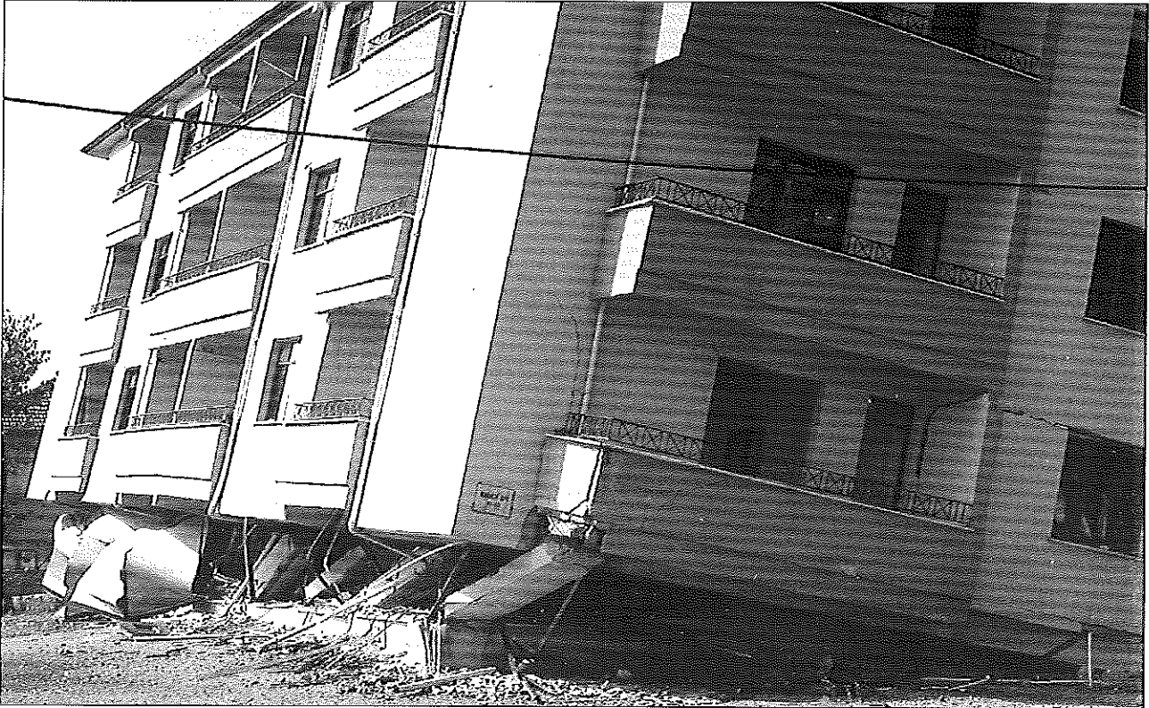
Resim 1 : Düzce'de alt katı mobilya satış yeri olan ve bölme duvarları bulunmayan bir binanın depremden sonraki durumu.
